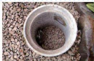
雨水浸透ます
