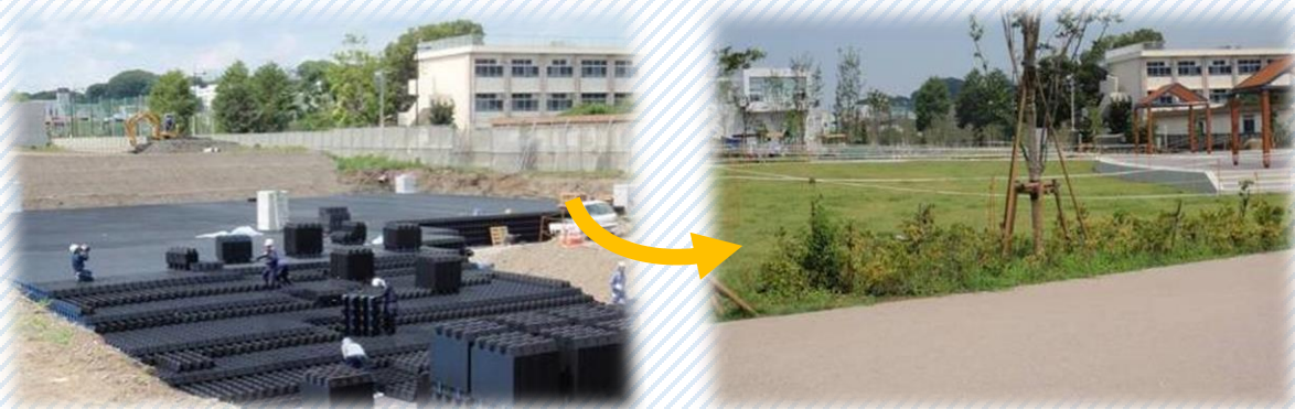
▲広場の地下に埋設されている雨水貯留施設（二子玉川公園）
