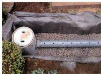
雨水浸透ます（上）、雨水浸透管（下）
