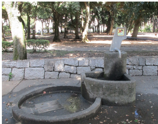
マンホールトイレ用井戸
