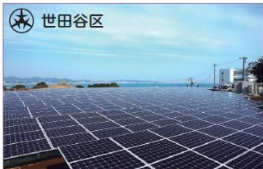
みうら太陽光発電所
