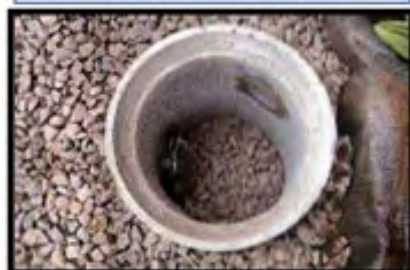
雨水浸透ます
