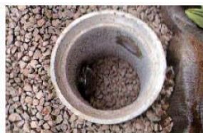
雨水浸透ます
