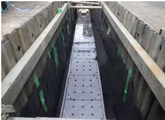
プラスチック製地下貯留浸透槽
