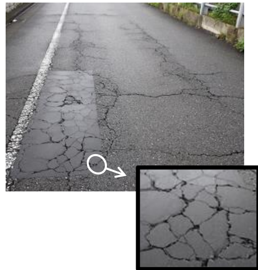
ひび割れ率 25%程度 安全性に問題あり
