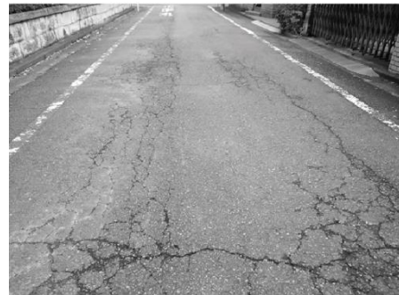
舗装厚の不足により、 車輪通過部に亀甲状のひび割れが発生
