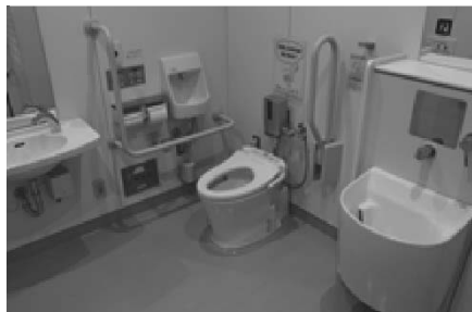
1階の災害時対応トイレ
