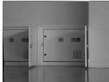
体育館内の非常用コンセント
