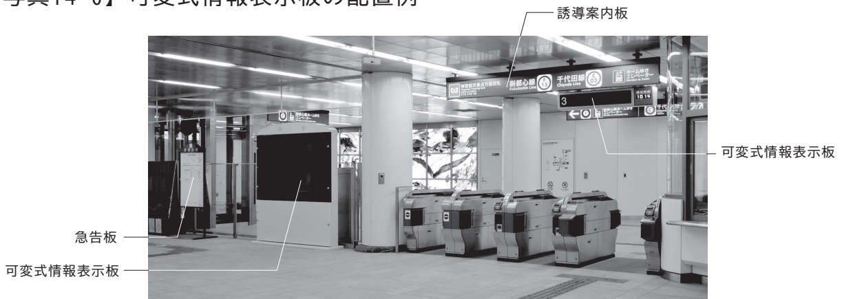
【写真14-6】可変式情報表示板の配置例
