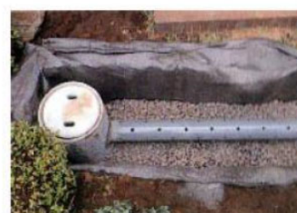
浸透(トレンチ)管
