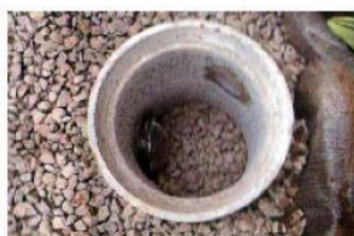
雨水浸透ます
