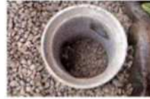
雨水浸透ます
