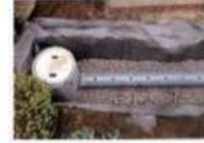
浸透（トレンチ）管
