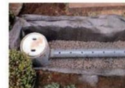
浸透（トレンチ）管
