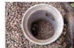
雨水浸透ます
