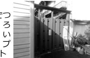
【写真2】行き止まりにつけた緊急避難路用扉
