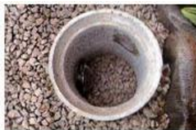
雨水浸透ます
