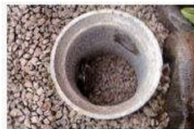
雨水浸透ます
