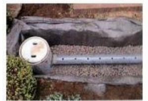
浸透(トレンチ)管
