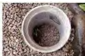
雨水浸透ます
