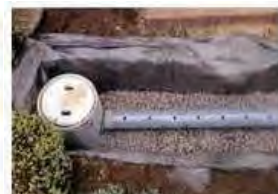
浸透(トレンチ)管
