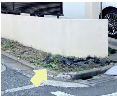
拡幅部分が未整備
