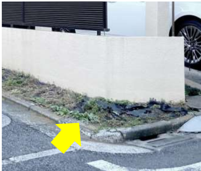
拡幅部分が未整備
