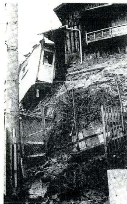
阪神大震災で被害を受けた擁壁
