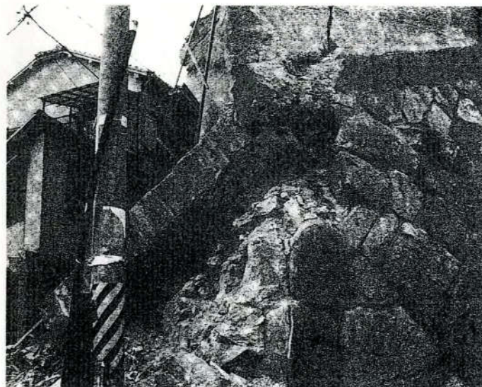
阪神大震災で被害を受けた擁壁
