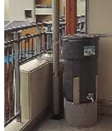
雨水貯溜タンク
