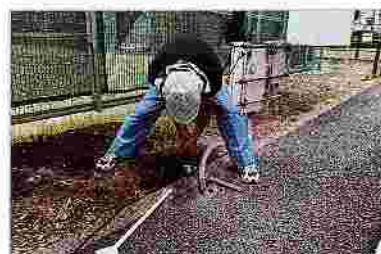
配線露出に伴う一次措置
