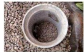
雨水浸透ます
