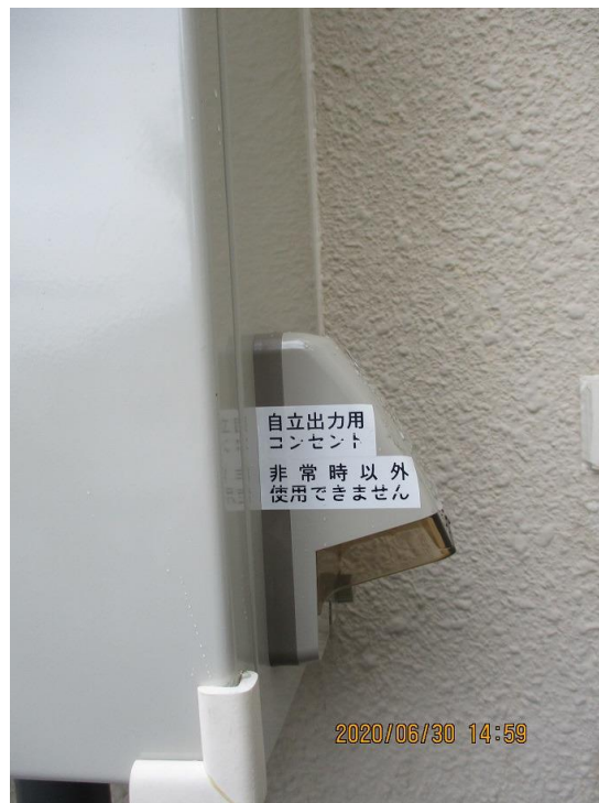
<非常用コンセント>
