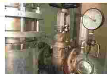
機械設備の老朽化
