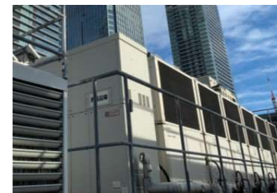
屋上の省エネ設備
