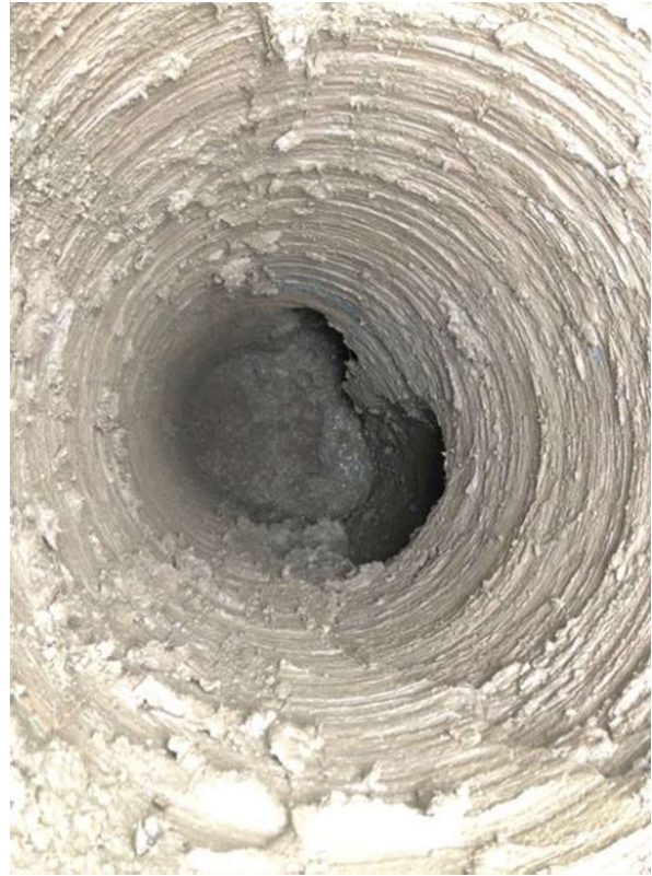
杭No.110 地中空洞位置：現況地盤より約2.2m下
