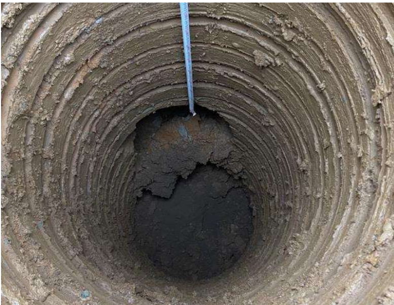
杭No.78 地中空洞位置：現況地盤より約2.0m下
