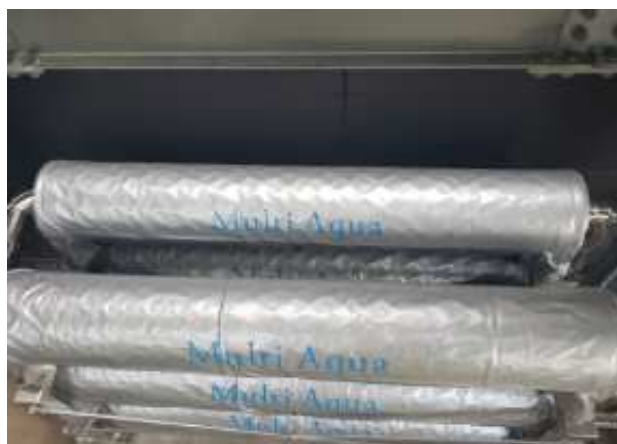
④ 非常用貯水機能付き給水管
