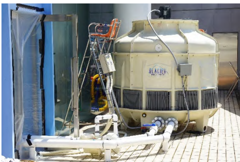
プールの水温を下げる冷却器
