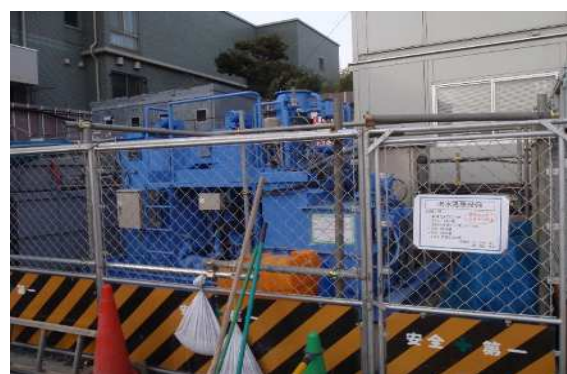
濁水処理設備
