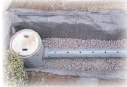
雨水浸透管・浸透樹
