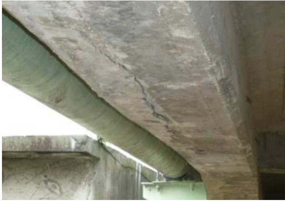
ひびわれ（主桁）
