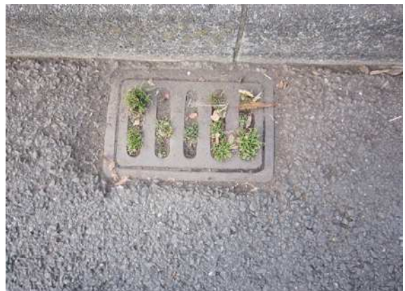
土砂詰り（排水ます）
