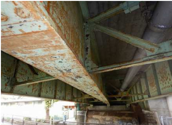
塗装劣化（主桁）
