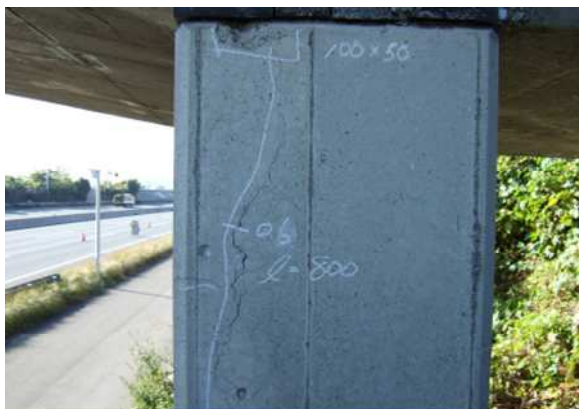
ひびわれ（橋脚）
