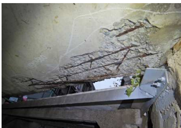
剥離・鉄筋露出（主桁）
