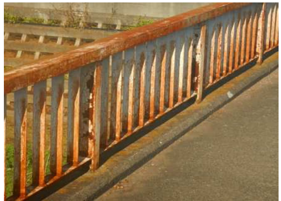
塗装劣化（高欄）
