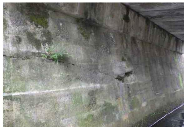
ひびわれ（橋台）
