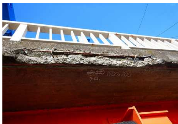
剥離・鉄筋露出（地覆）
