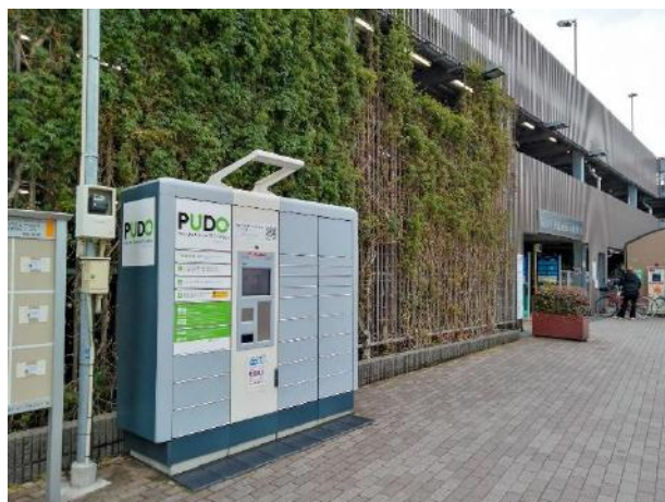
図 92 駐輪場前に設置した宅配ボックス（烏山中央自転車等駐車場）
