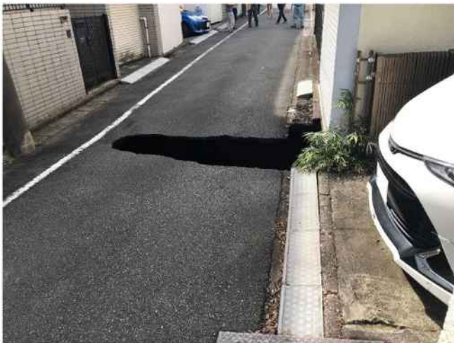
写真4 陥没箇所(2020年10月18日_12:30)
