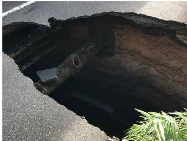
写真5 陥没箇所(2020年10月18日_13:00_東側から撮影)
