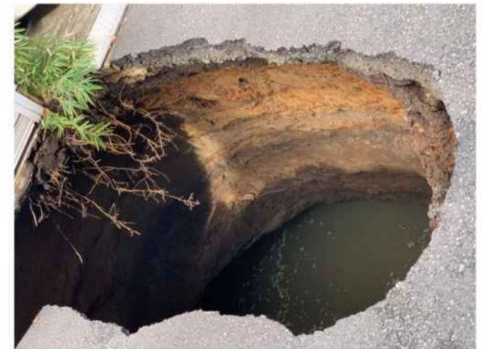
写真6 陥没箇所(2020年10月18日_13:00_西側から撮影)
