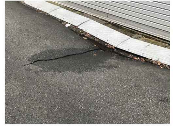
写真3 陥没箇所(2020年10月18日_11:50_舗装亀裂)
