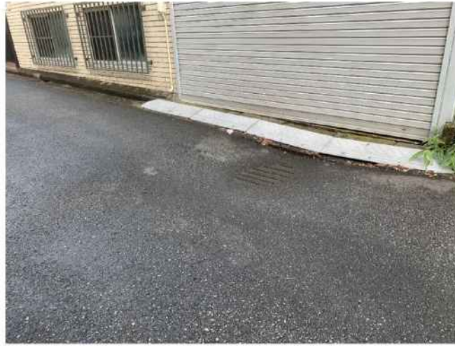
写真2 陥没箇所(2020年10月18日_9:30水たまり)
