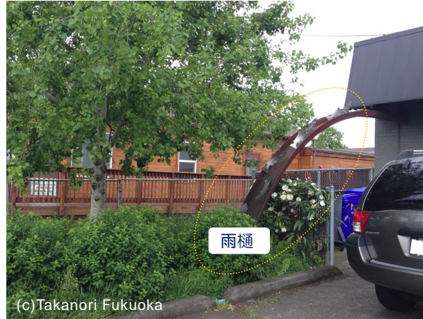
雨樋から庭へ雨水が浸透する(雨樋非接続)
