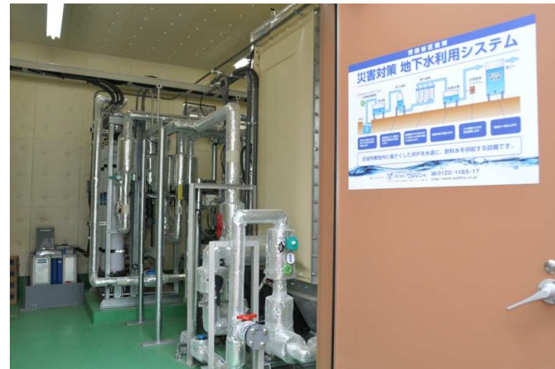
地下水利用システム
