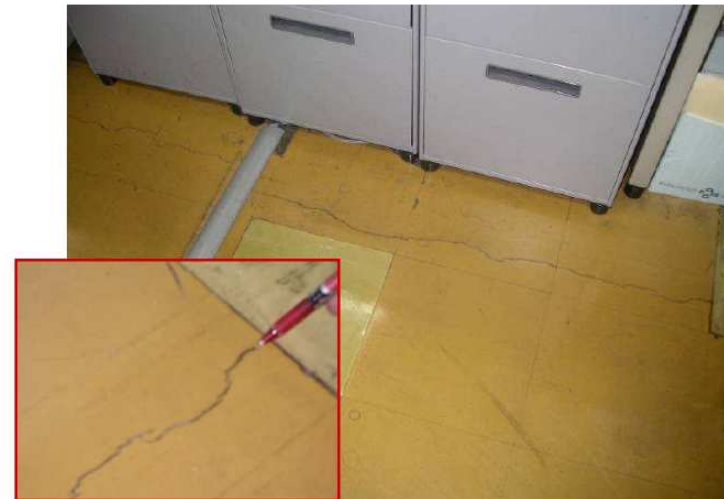
床のクラック(ひび割れ)(第1庁舎)
