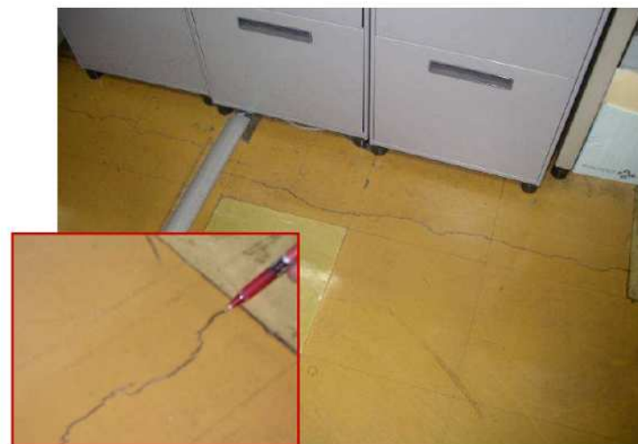
床のクラック(ひび割れ)(第1庁舎)
