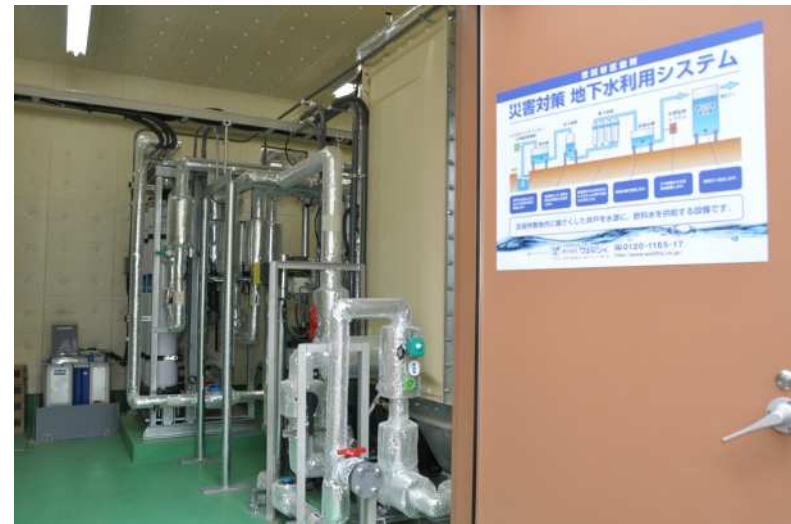
地下水利用システム
