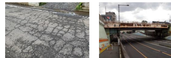
【参考】道路施設の劣化イメージ
