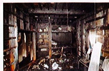
火災が発生した居室
