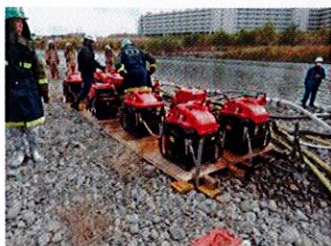
配置された可搬ポンプ
