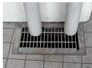
建物の排水ます
