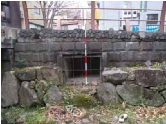
図-11 余水吐 (稲荷橋)
