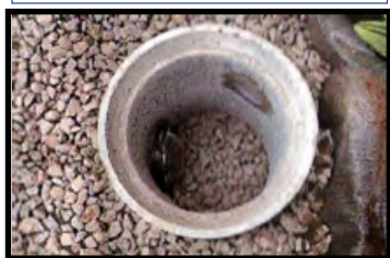
雨水浸透ます
