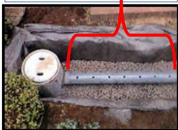
雨水浸透トレンチ
