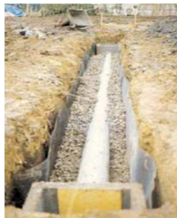
雨水浸透トレンチ
