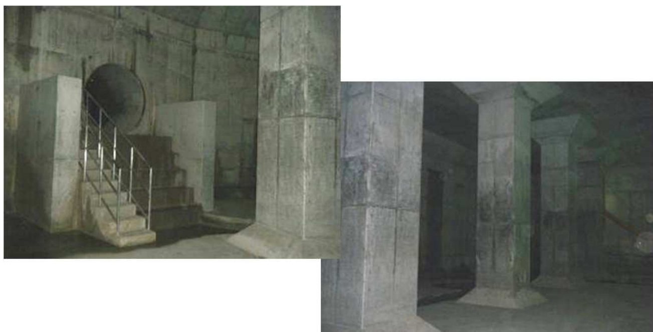
小泉公園雨水調整池
