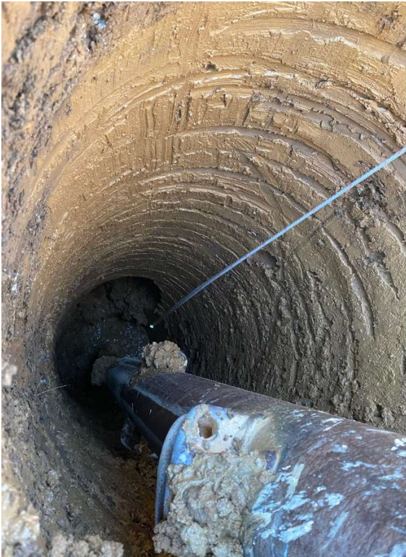
杭No.21 地中空洞位置：現況地盤より約2.4m下
