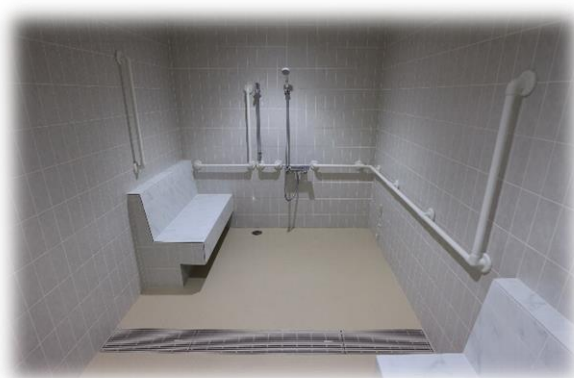
だれでもシャワー室
