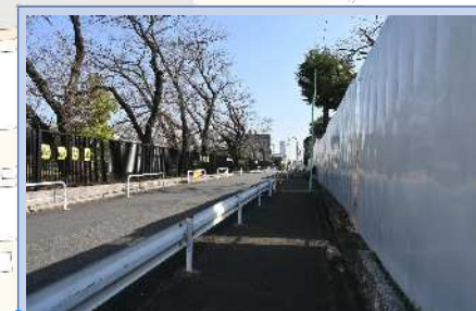
既存開園地との境界部は路上駐車禁止のための防護柵が設置されています。
