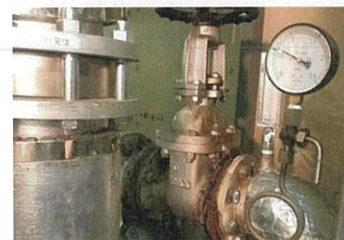
機械設備の老朽化
