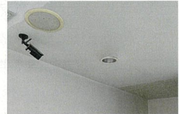
防犯カメラの設置
