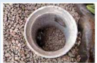
雨水浸透ます
