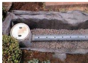
浸透（トレンチ）管
