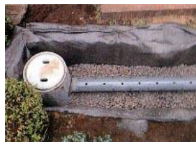
浸透（トレンチ）管
